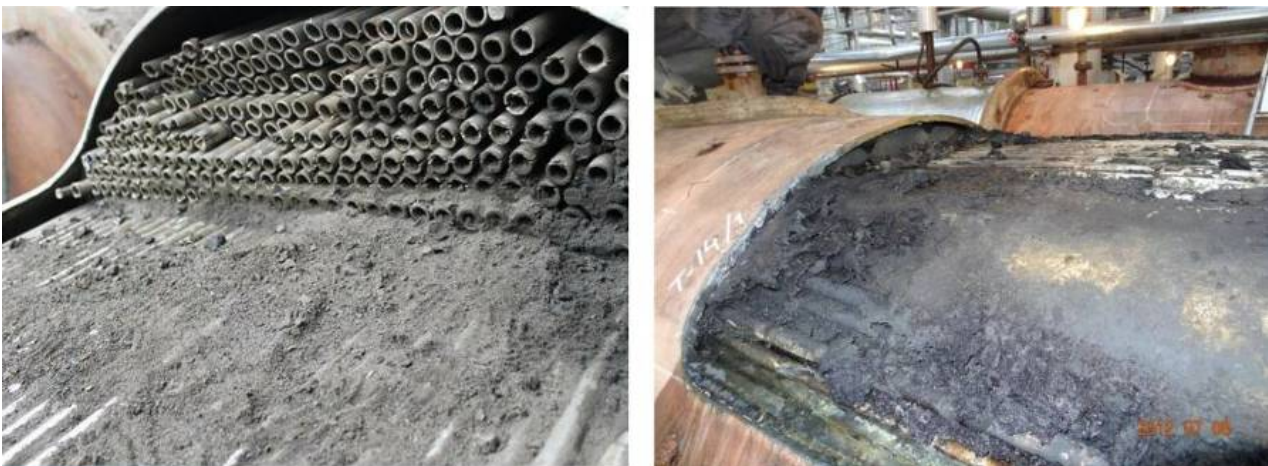
Рис. 8. Теплообменник при вскрытии.
